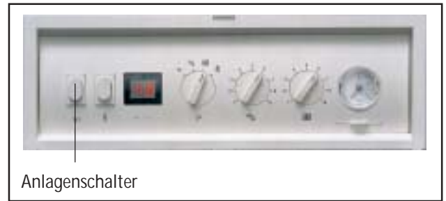
Bild: Gesamtansicht Regelung
