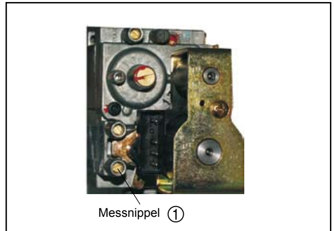
Bild: Überprüfen Gasanschlussdruck
