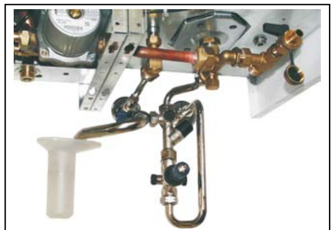
Bild: Zubehör Unterputz montiert
